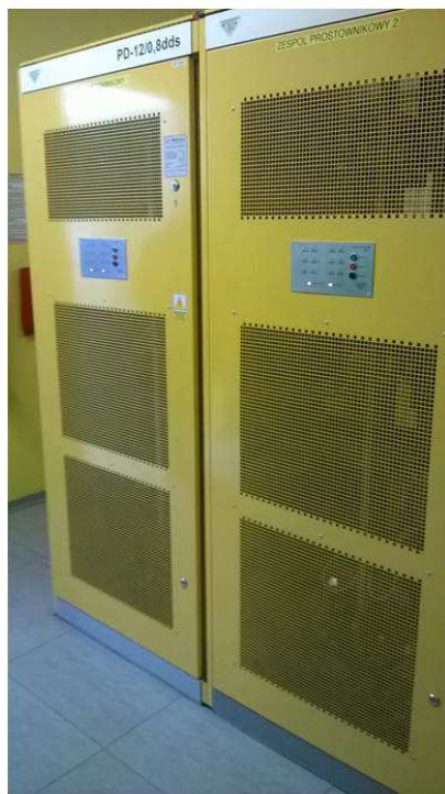
Fot.6 Prostownik tramwajowy w podstacji trakcyjnej
